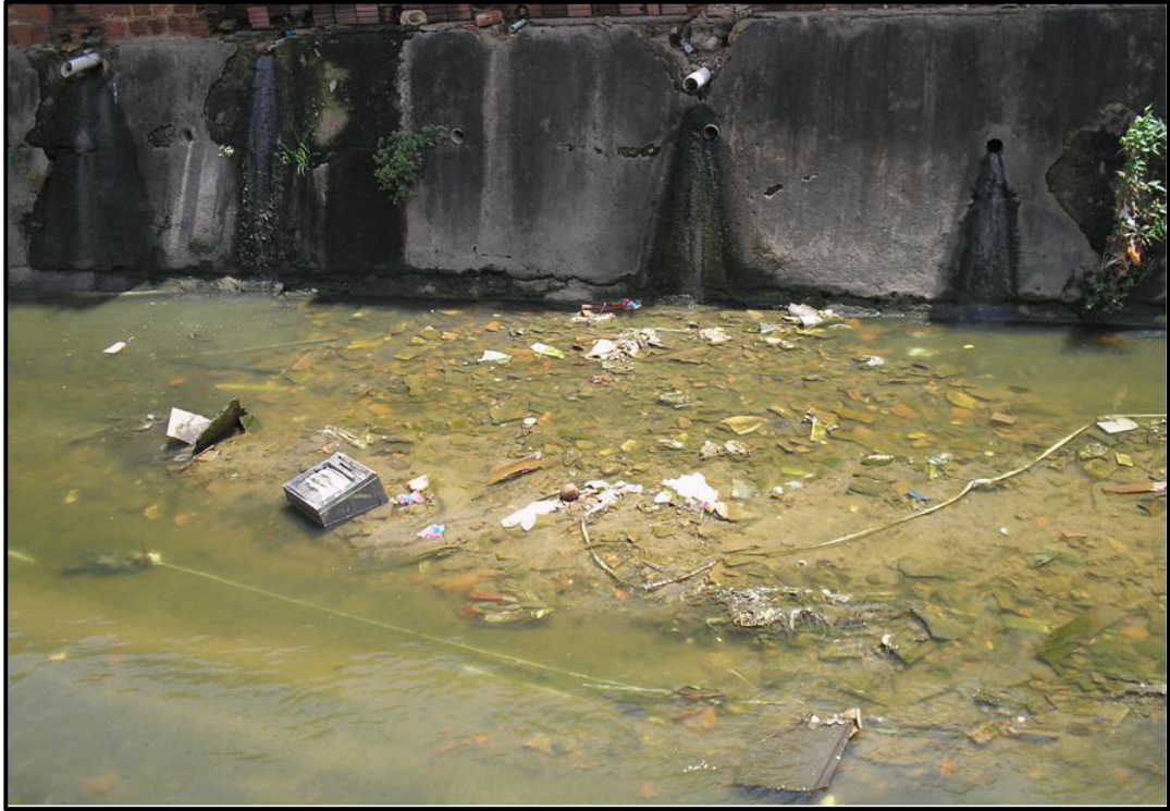
Figura 1-1-8. Lançamento de esgotos domésticos no canal que deságua no Açude
